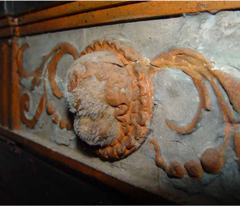
Detail einer mit Schimmel befallenen Oberfläche
