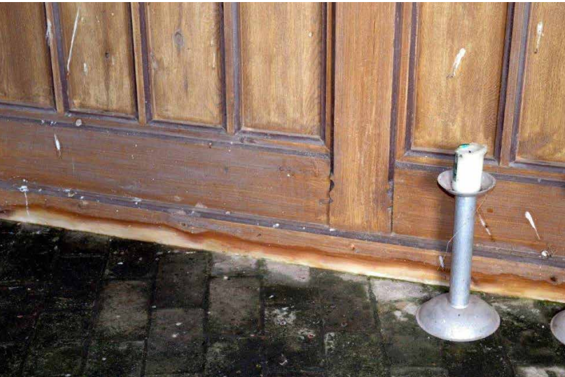
Räbel – Hansestadt Werben (Elbe): feuchter Fußboden
