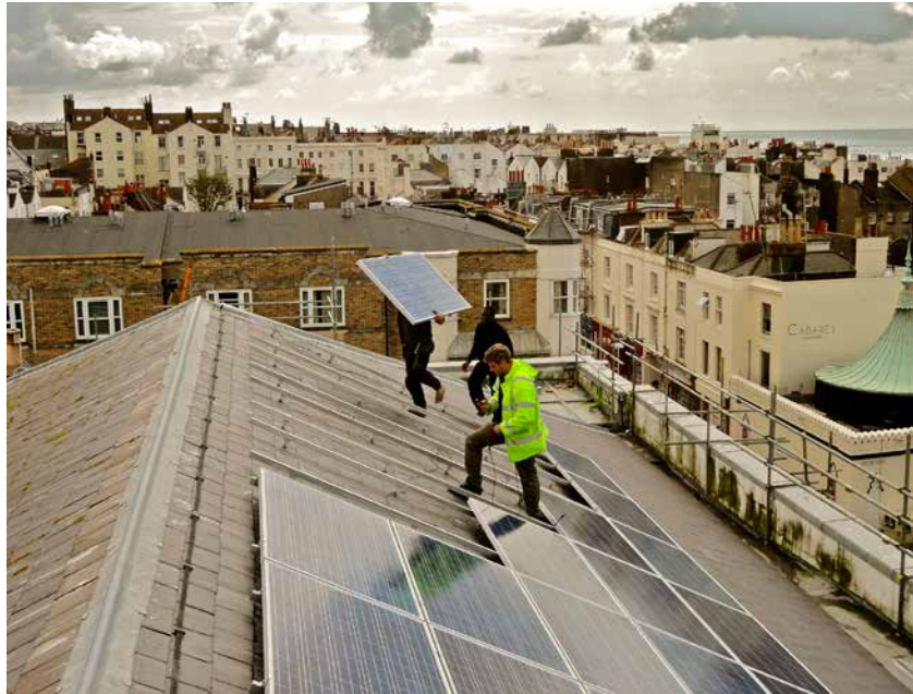
10-kW-Solaranlage auf dem Dach der Kirche St. George in Kempton, UK, die jährlich 10 500 kW Strom erzeugen soll. Die Kirche wurde in den 1820er Jahren erbaut und steht unter Denkmalschutz (Grade II).
