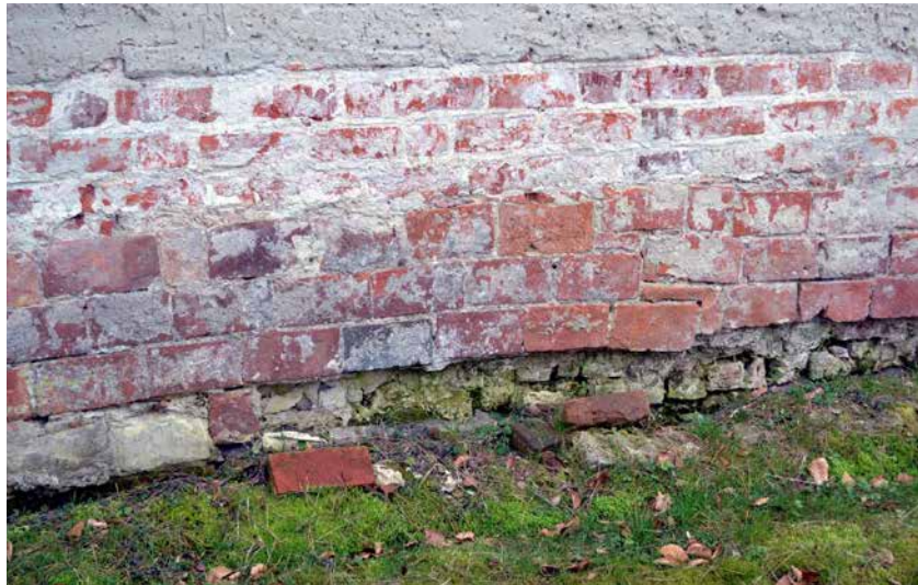
Sydow: abgänige Ziegelsteine durch erhöhten Grundwasserspiegel
