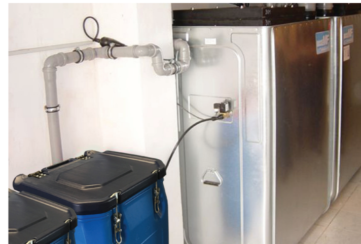
Die neue Phosphor-Eliminierungseinheit wird einer Membrankläranlage für einen 4 Personen-Haushalt/Einfamilienhaus nachgeschaltet.
